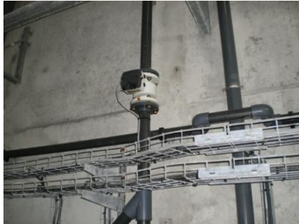
Débitmètre matières de vidanges
