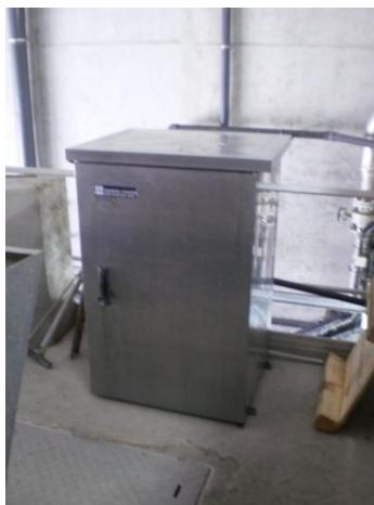
Préleveur entrée station
