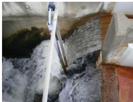
Point de prélèvement sortie station
